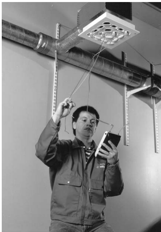
Injustering av luftdon med reglagesnören och mätslang.
