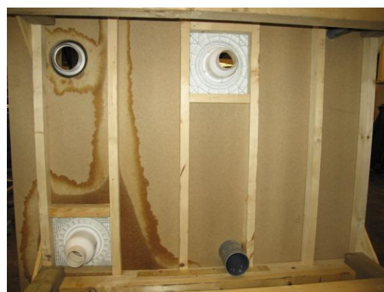
Nytestat våtrumsgolv underifrån
