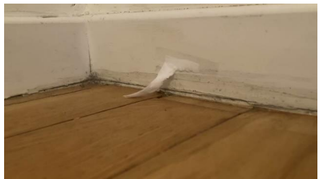
Kraftigt inläckage av luft vid golvvinkel mot yttervägg över soprum
